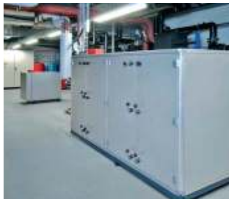
Heizraum mit Langzeitprüfung
